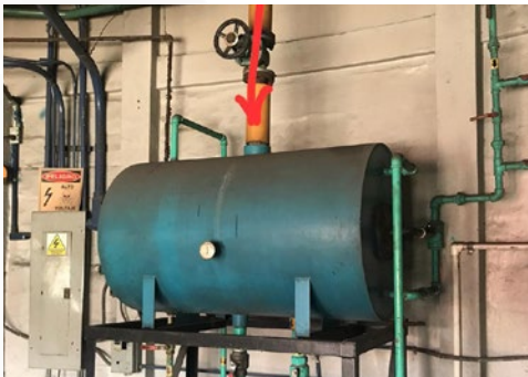
TANQUE ELEVADO Y BOMBAS.
