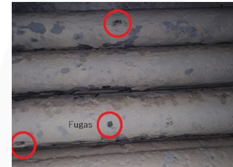
PICADURAS EN LOS TUBOS DE LAS CALDERAS.
